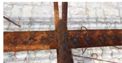
Figura 9: Falta de amarração das barras
